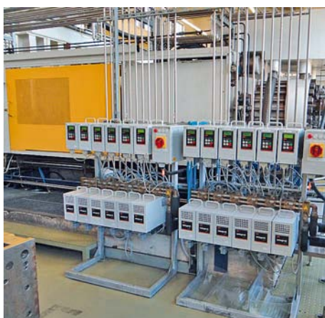
Temperierung mit Edelstahlverrohrung
